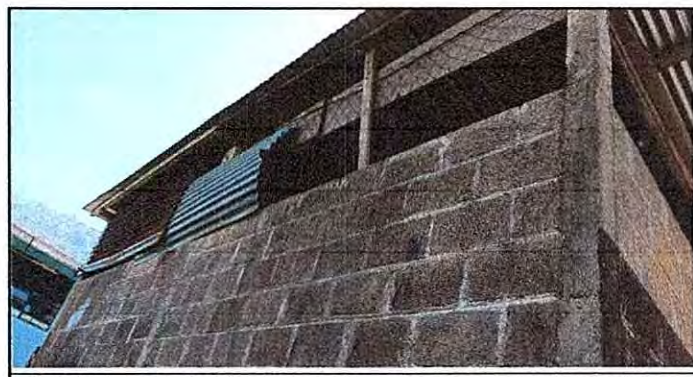
FOTO 12. Las paredes de aulas se encuentran en mal estado por el paso del tiempo. Es necesario el mantenimiento.
