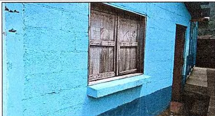
Foto 1: Las puertas y ventanas presentan daños severos por el paso del tiempo.
