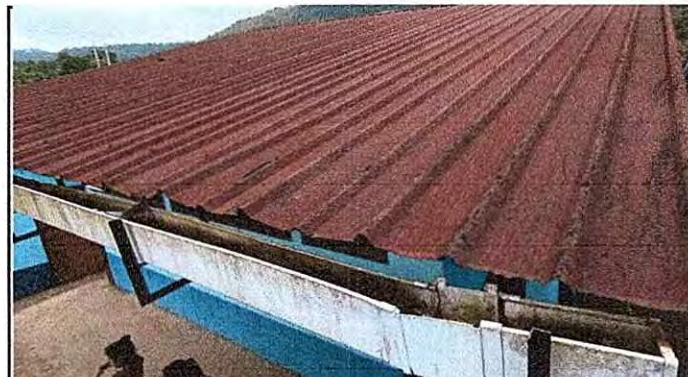
Fotos 4: la cubierta de lámina de un modulo ya esta muy gastada y cuando llueve fuerte se dificulta por las goteras.
