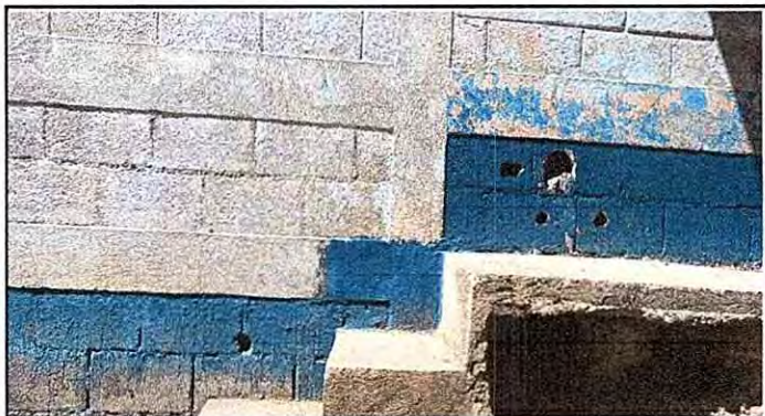
Foto 9: las paredes de aulas necesitan alisado o cernido para su conservación.
