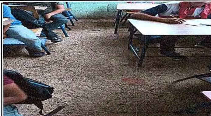
Foto 7: el entortado de las aulas esta en mal estado y necesita intervención inmediata.
