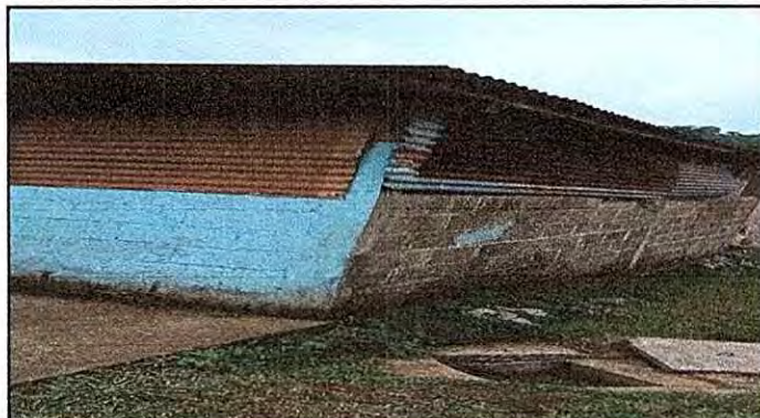
Foto 2: hay un módulo de dos aulas que presenta grietas y no cuenta con ventanales o balcones.
