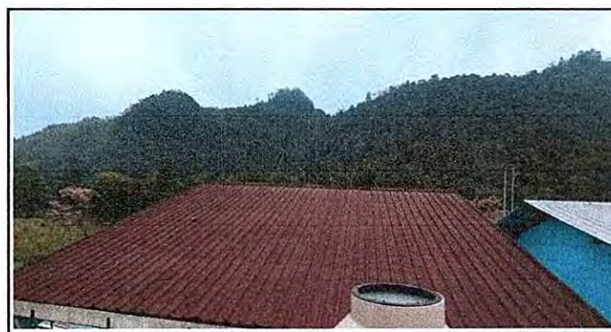
Foto 6: La cubierta de lámina presenta daño por las inclemencias del tiempo, es necesario cambiarlo.
