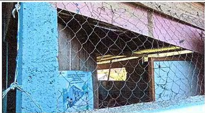
Foto 8: hay aulas que no cuentan con balcones, ventanas o vidrios.
