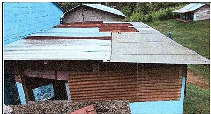
Foto 3: El techo de aulas presenta goteras, es informal y presenta daños que afecta las clases.
