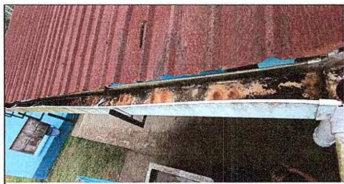
Foto 5: el canal de agua ya esta quebrada y muy antigua por lo que es necesario su cambio.
